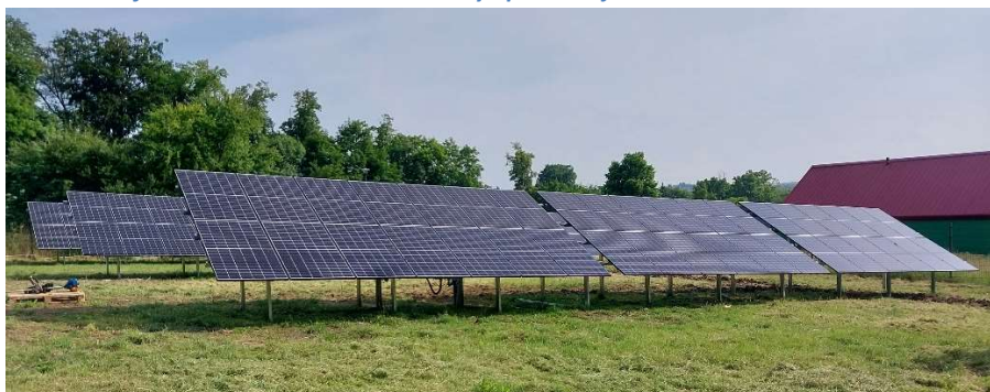
Fot. Panele fotowoltaiczne w Domu Pomocy Społecznej w Batowicach
